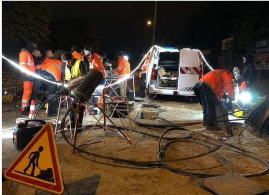
Vitry-sur-Seine (Val-de-Marne), dans la nuit de mardi à mercredi. Les équipes d'Orange s'efforcent de rétablir le réseau au plus vite. Ces détériorations des câbles de téléphonie seraient l'acte « d'une seule personne équipée d'une disqueuse », avance l'opérateur.
